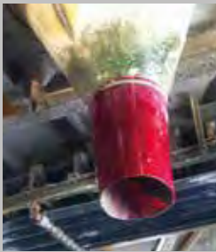
▲ Ein PUCEST ® Auslaufschlauch nach einer Standzeit von ca. 100.000 m 3
