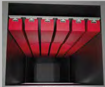
3. Die Modul-Bausteine im verschlissenen Zustand
